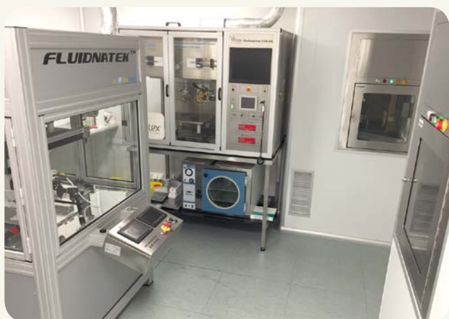
Imagen 1. Instalaciones de la nueva sala blanca ISO 5/Clase B de AITEX.
